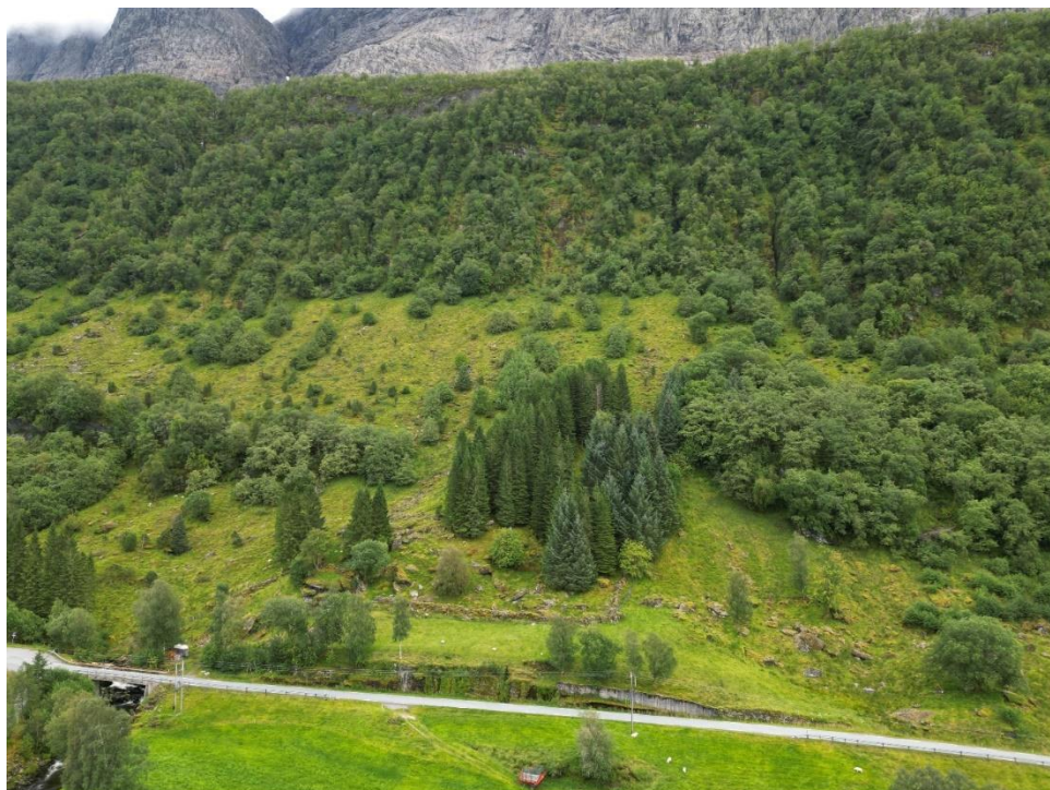
Figur 10: Langs med vegen fra bru og ca. 100 m mot vest ses berg i dagen i skjæring langs eksisterende veg.
